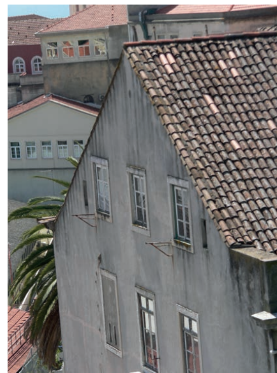
Fig. 1 Façades in South European Countries with severe microbial growth Facciata di edifici in Paesi Sud Europei, con una severa crescita microbica
