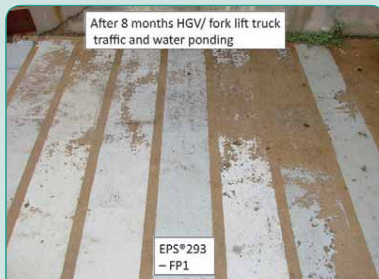
Fig. 5 EPS® 293 – FP1 dopo l'esposizione in ambiente esterno per 8 mesi EPS® 293 - FP1 after 8 months exterior exposure
